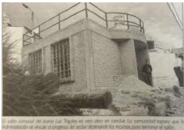
Figura 29. Denuncia por un salón comunal inconcluso en el barrio Los Trigales
