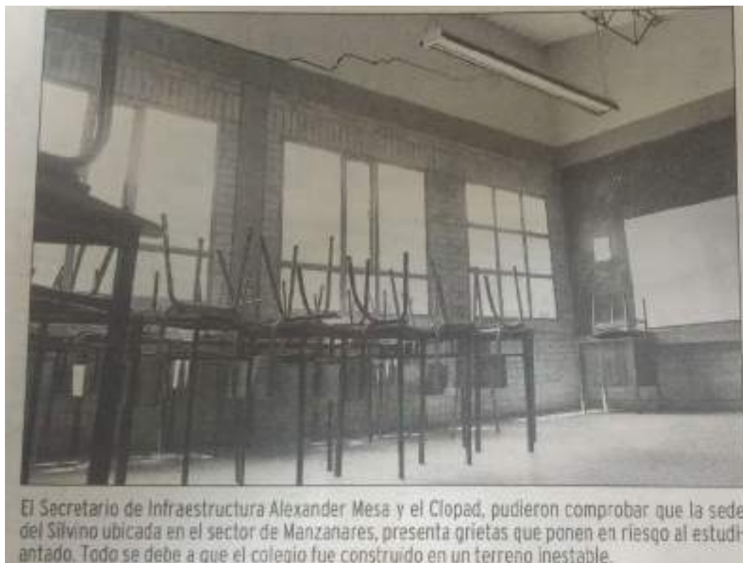
Figura 96. El colegio Silvino en crisis debido a los agrietamientos en sus instalaciones, consecuencia de haber sido construido sobre terreno inestable
