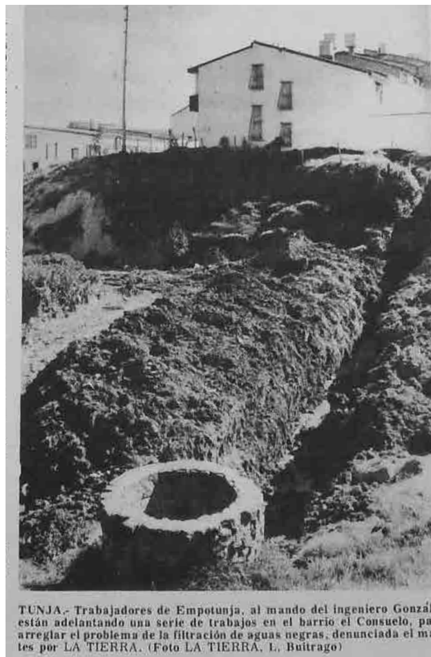
Figura 34. Arreglos del alcantarillado del barrio El Consuelo
