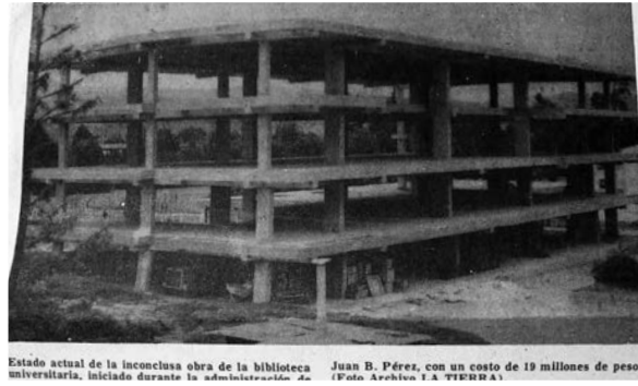
Figura 83. Edificación inconclusa de la biblioteca de la UPTC
